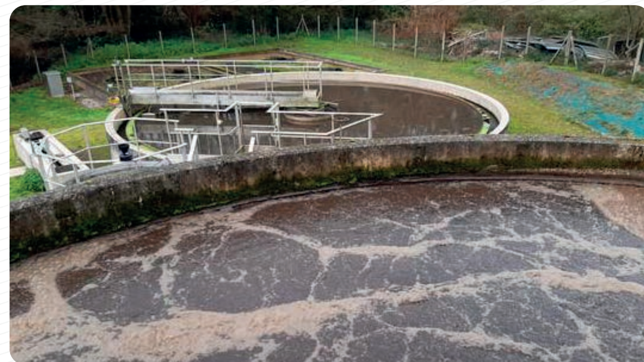
| Figure 12 : vue du bassin d'aération et du clarificateur de la station d'épuration de Saint-Perdon
